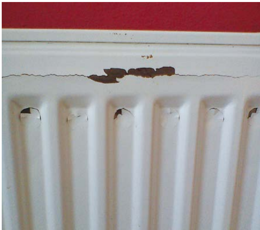
Silný mráz dokáže výrazne poškodiť radiátor
