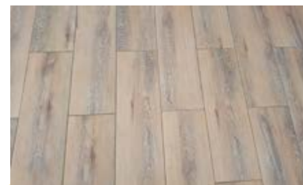
Nesprávne uložená dlažba
